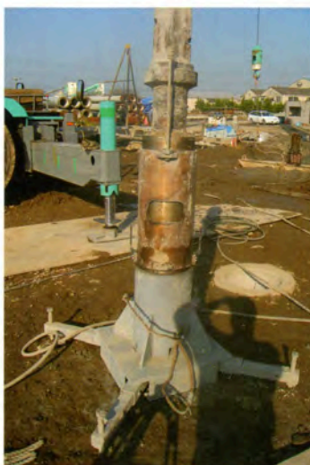
外管閉塞状態
